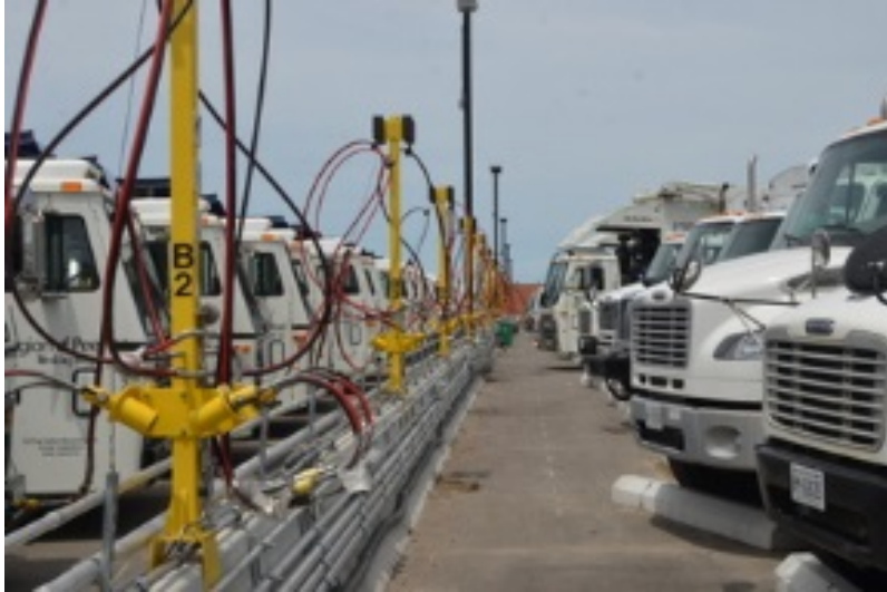
Figure 2. Installation de ravitaillement en gaz naturel comprimé d’Emterra située à Mississauga et munie de nombreux poste de ravitaillement lent de nuit.
